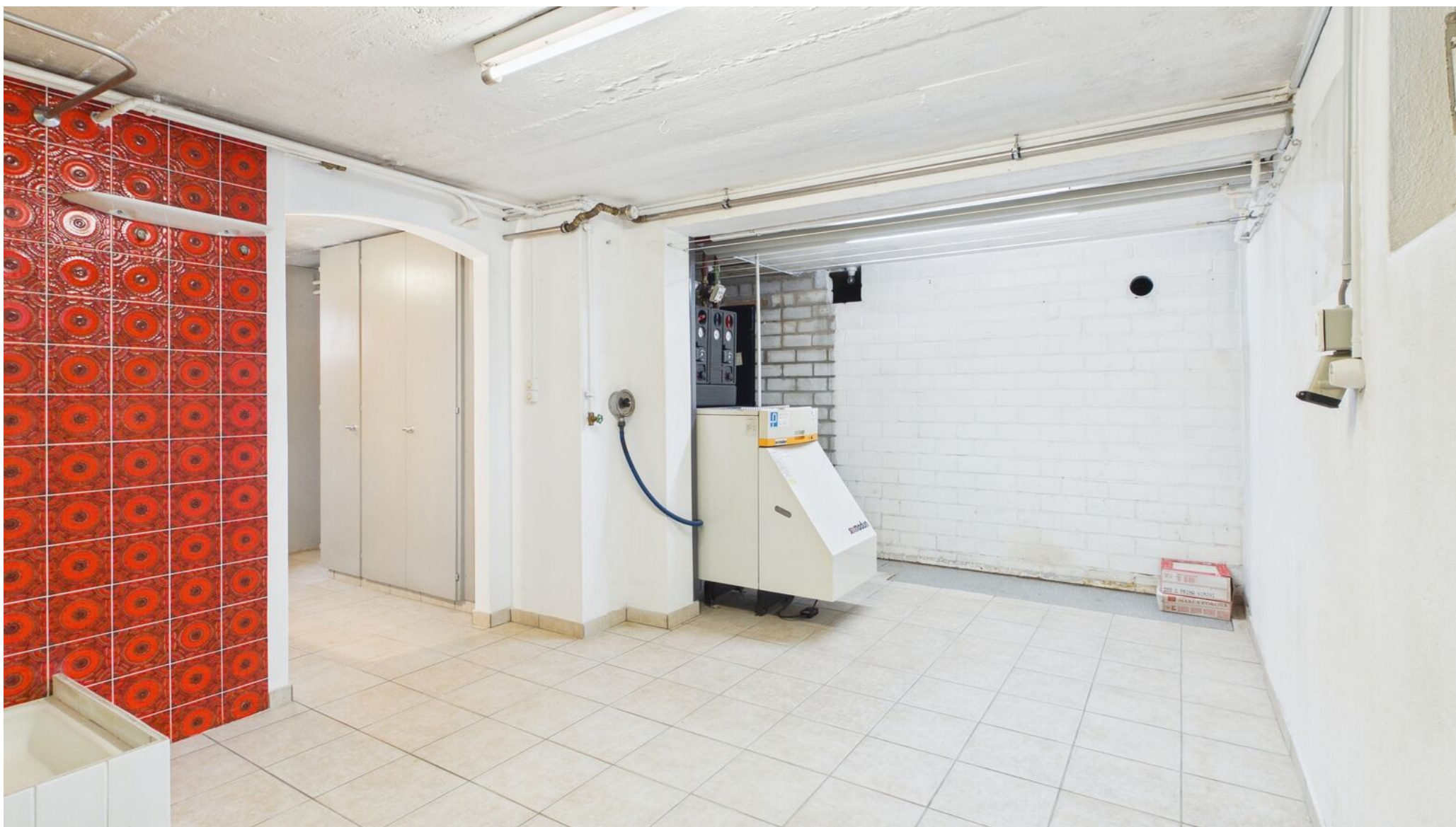
Keller mit Dusche / Heizung UG
