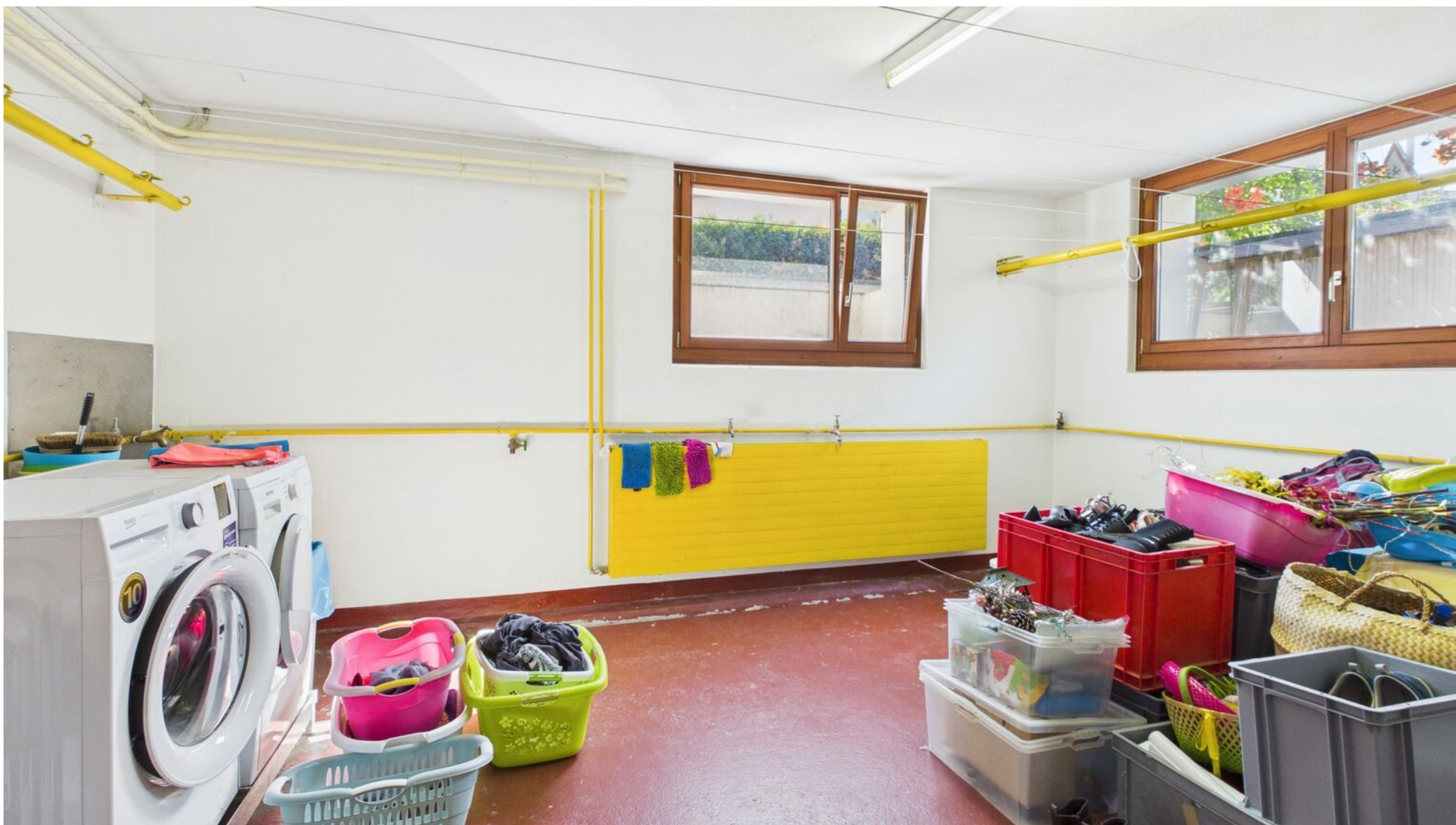
Waschküche beheizt UG
